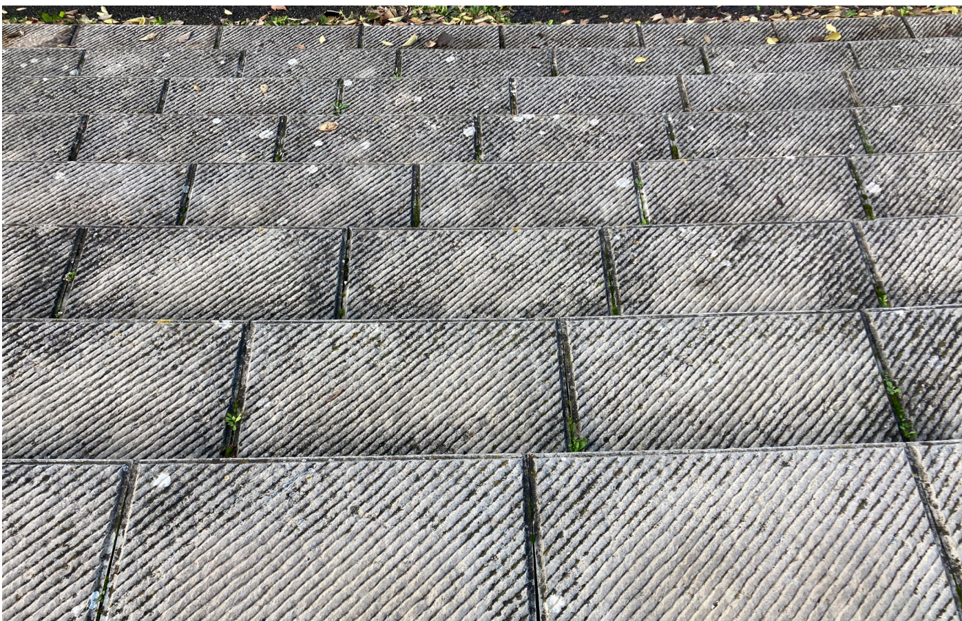
2.5 Scale: Realizzata in unico materiale (alzata e pedata) costituisce una fonte di pericolo perché non consente una corretta individuazione della pendenza
