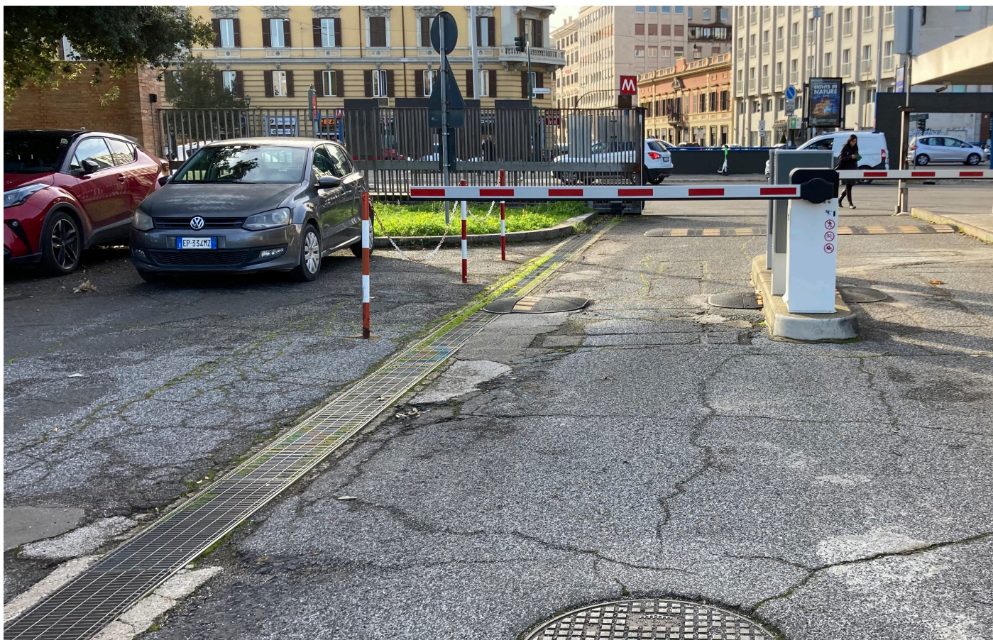
1.4.a) Parcheggi scoperti : La pavimentazione dell'area parcheggi interna, risulta fratturata e discontinua, inoltre non vi è la segnaletica prescritta dalla legge per i parcheggi destinati a persona su sedia a ruote.
