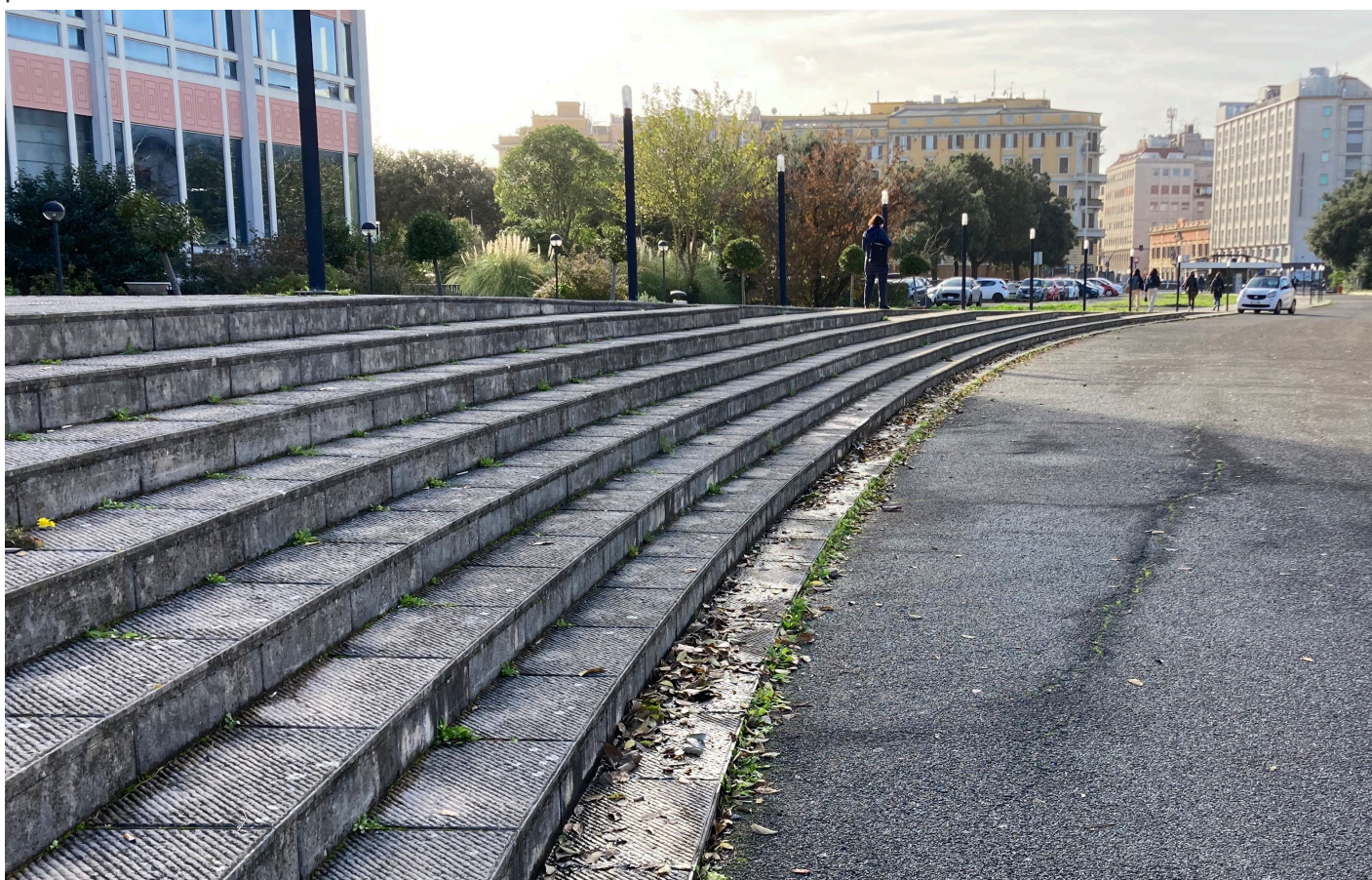
2.4) Rampa : I due bordi della rampa, di cui nella foto si vede solo quello che sviluppa la scalinata appaiono esposti al rischio di caduta. Vanno quindi valutati eventuali sistemi di protezione dei bordi.
