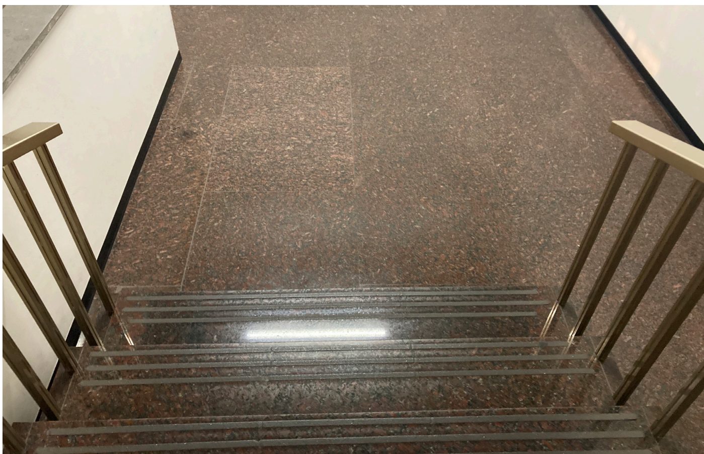
5.2) Scale: La rampa di scale che conduce alla zona uffici presenta una finitura di granito scuro riflettente per le alzate e per le pedate. I marca-gradino antiscivolo non contrastano però dal punto di vista cromatico
