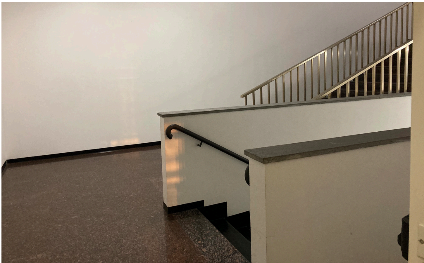
5.2) Scale: Il corrimano della rampa di scale non prosegue sul pianerottolo di sbarco
