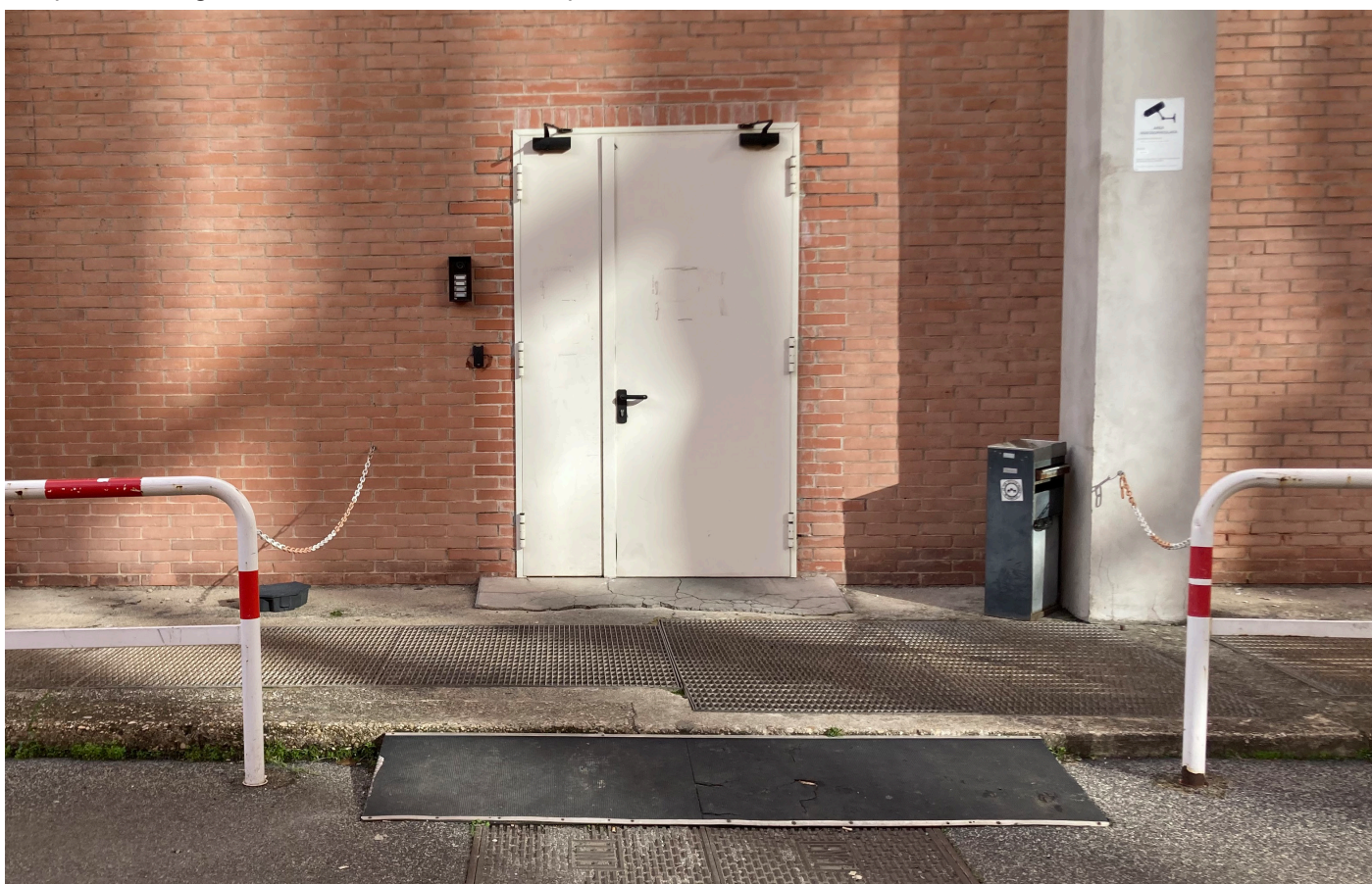
1.4.b) Parcheggi coperti : La porta di accesso alla stecca degli uffici dall'area dei parcheggi coperti avviene in uno spazio scoperto attraverso un tratto di pavimentazione costituita da una rampa di cemento mal raccordata.
